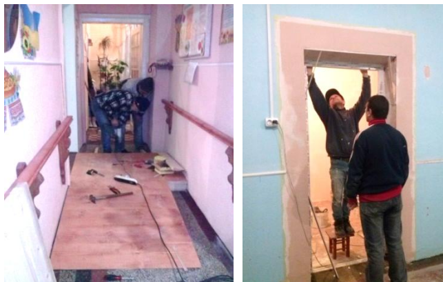
Облаштування безбар'єрного доступу дітям із складним діагнозом до приміщення Центру «Дзвіночок» за фінансової підтримки італійських партнерів
