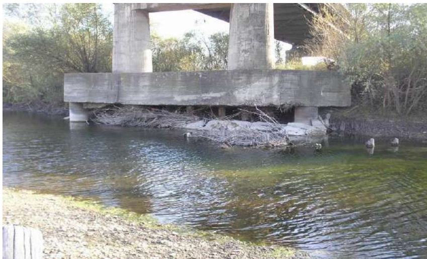
Додаток 15. Підмив опори мосту в с. Дубівці (фото після паводку 2008 року)
