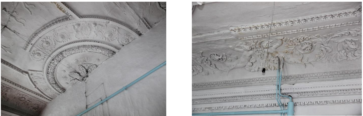
Рис. 1. Руйнування ліпнинного декору стелі, палац у с. Ілляшівка, Хмельницької обл. Фото автора
