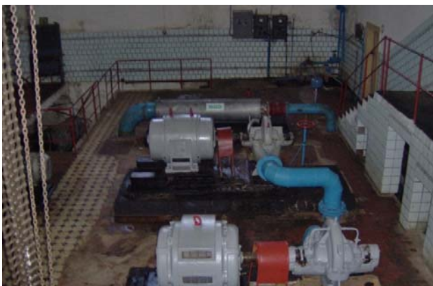
Рис. 5.33. Насосна станція «Магала» II підйому
