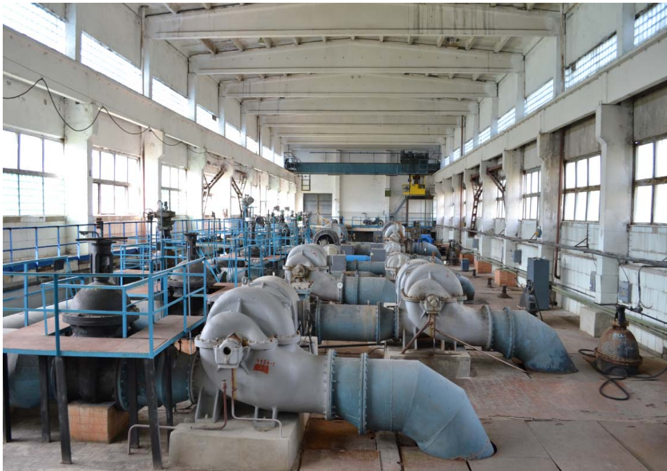
Рис. 5.20 Насосна станція «Вікно» II підйому
