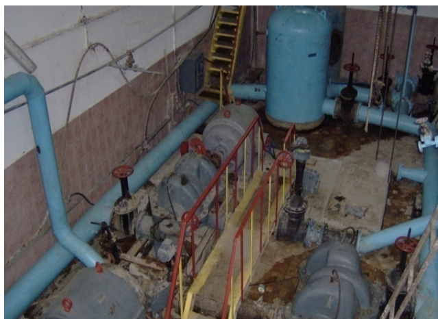
Рис. 5.31. Насосна станція «Біла» II підйому
