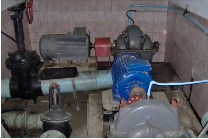
Рис. 5.29. Насосна станція Біла I підйому
