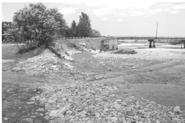
Рис. 2.12. Розмив лівого берега і полотна дороги перед мостом через р. Лімницю у сmt Перегінське
