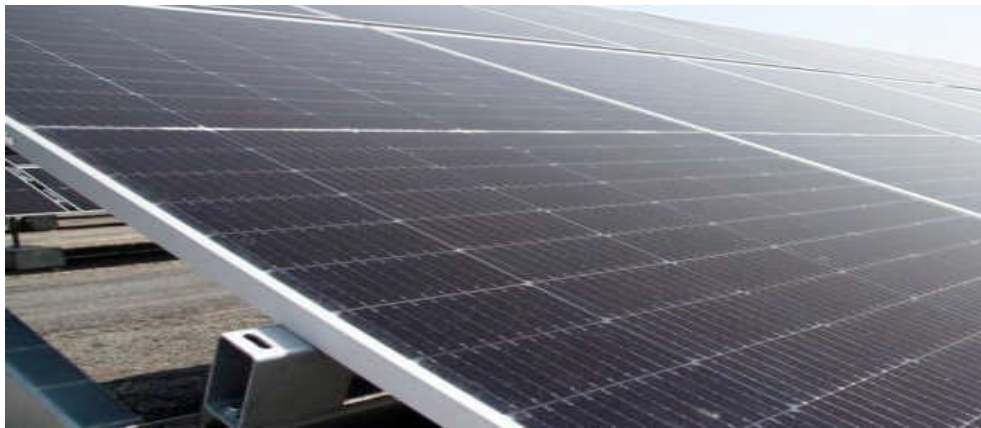
Рис. 1. Сонячна електростанція на Полтавщині
