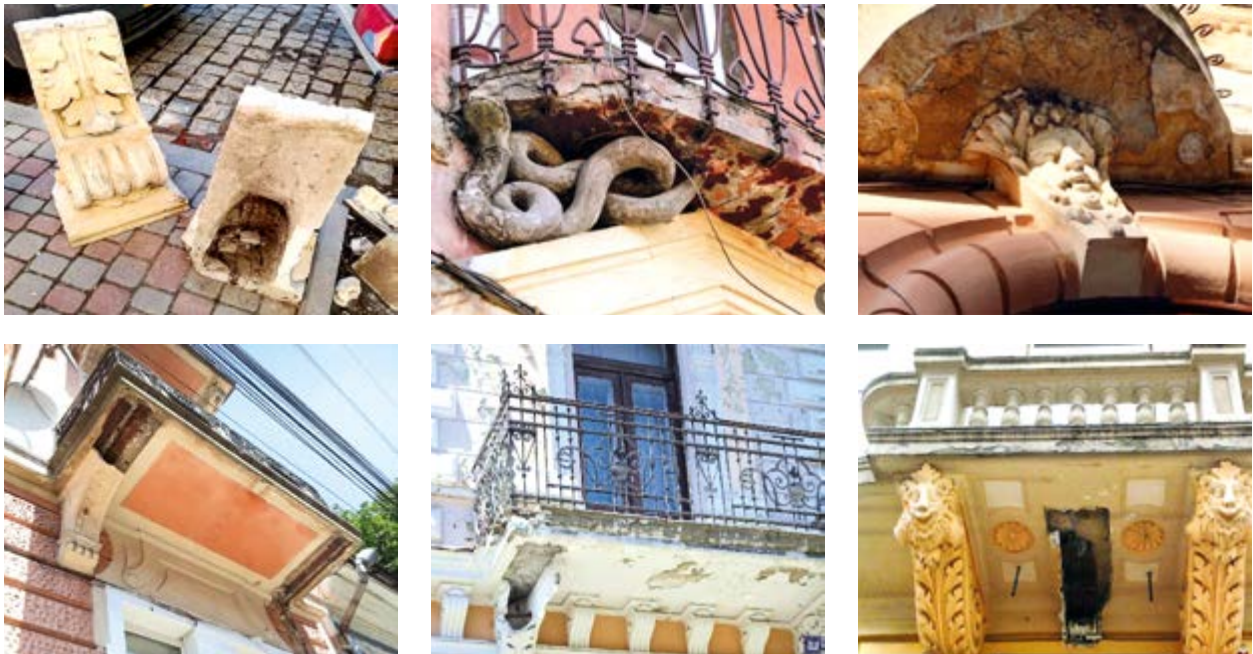
Рис. 8.31. Приклади деструкції елементів декору балконів, м. Чернівці
