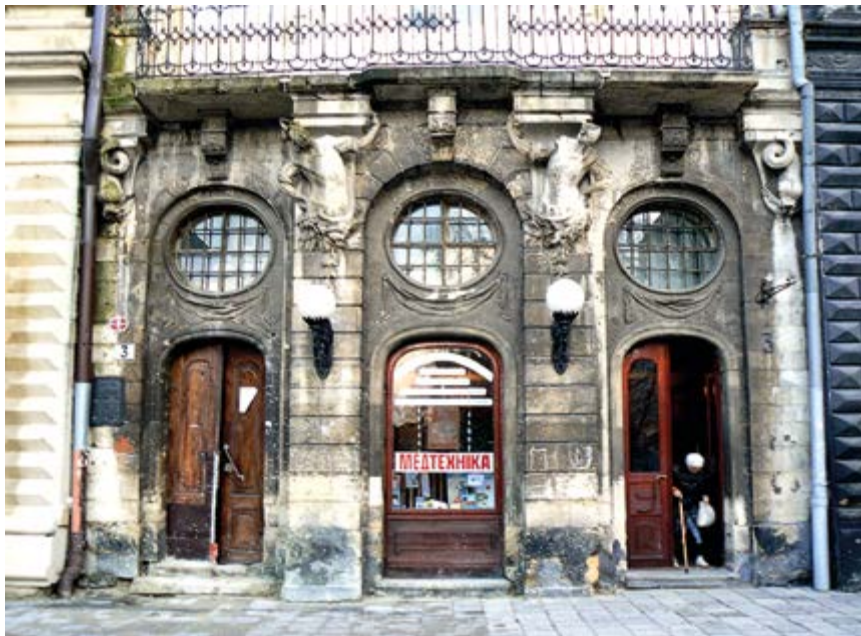
Рис. 8.8. Приклад негативного впливу зволоження фундаментів на кам'яну кладку фасаду. Будинок на пл. Ринок, 3, м. Львів, пам'ятка архітектури XVIII ст. (охор. № 326/2-Н).
