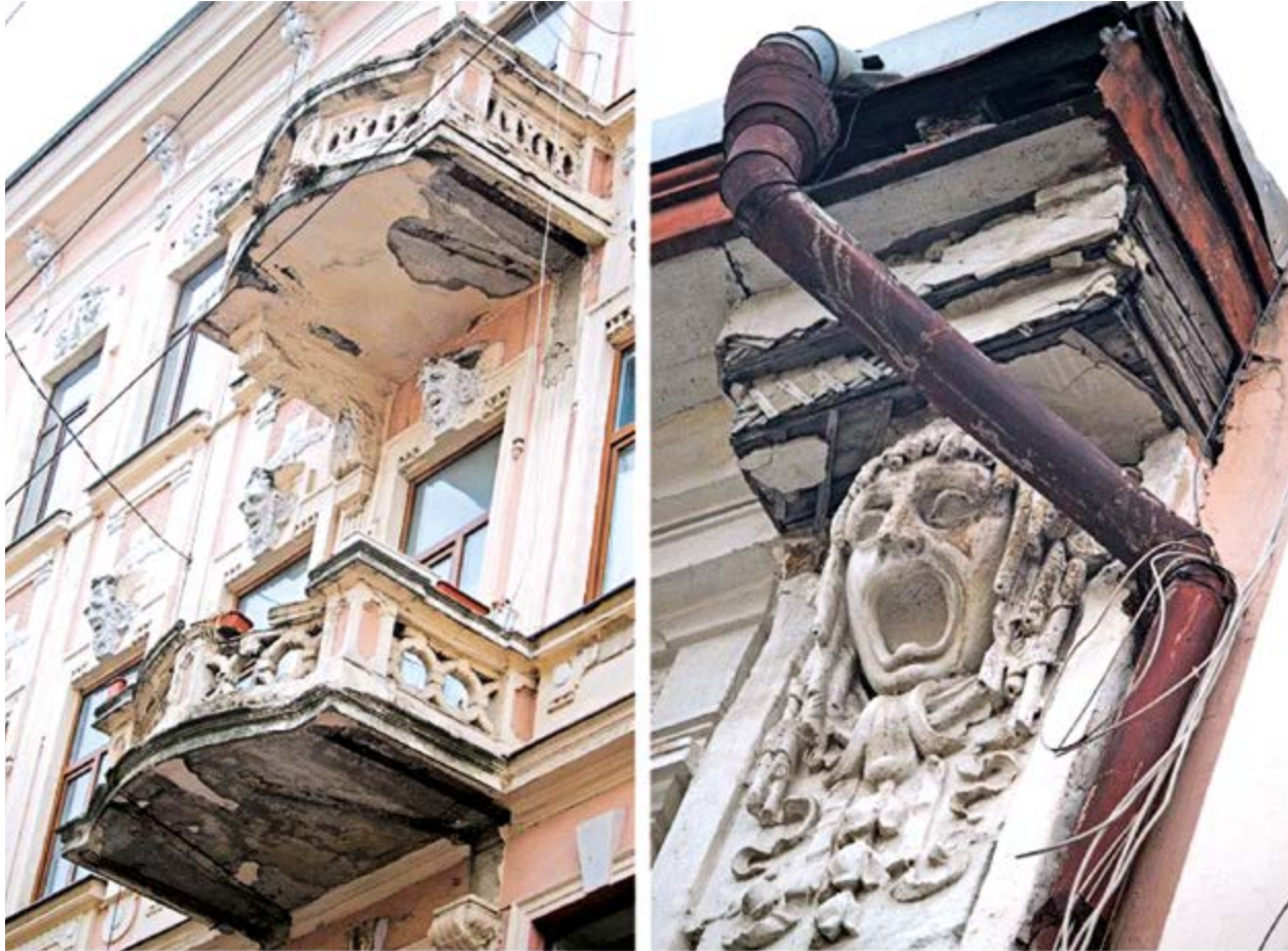
Рис. 8.14. Приклади ураження і втрат штукатурного шару фасадів через замокання. Чернівці, вул. А. Кохановського, 2 (фото Є. Карпенко, 2019)
